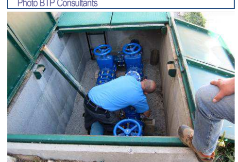
Nettoyage du filtre du régulateur de pression du réseau basse pression à Corbières – Photo BTP
