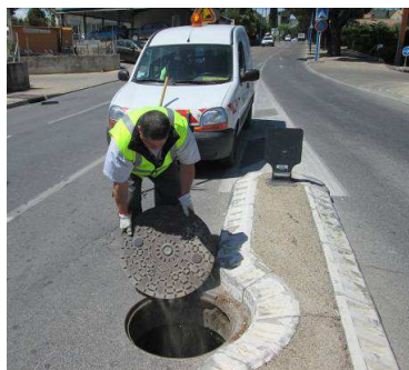
Manœuvre d'une prise d'eau d'une filiole busée en centre-ville de Manosque située au niveau de la voirie – Photo BTP Consultants
