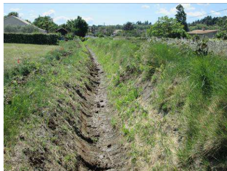
Curage d'une filiole à Manosque à l'aide d'une mini pelle par l'entreprise PAGLIANO – Photo BTP Consultants
