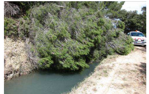
Pin tombé fin mars au niveau du canal maître à Lurs – Photo BTP Consultants
