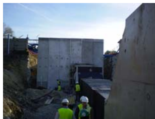
Site SILPRO Siphon permettant la traversée du Barasson
