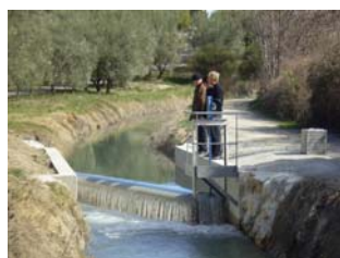
Seuil hydraulique Ouvrage en fonctionnement
