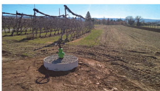
Borne d'irrigation agricole – Tranche 5 Manosque Est
